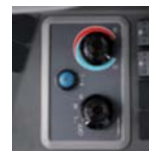
Cuadro de control del aire acondicionado
